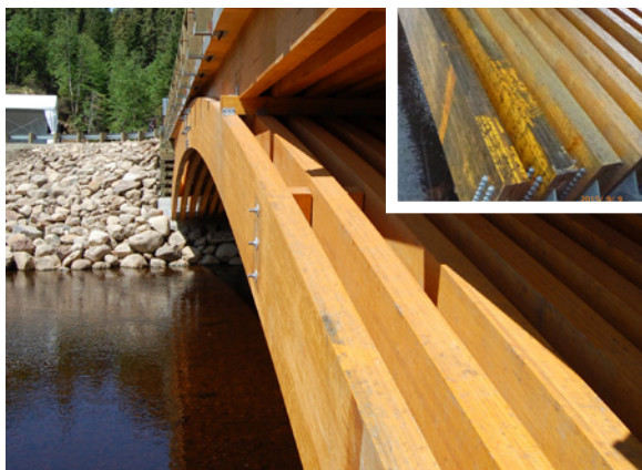
FIGURE 10 - Protection insuffisante contre la pluie et les rayons UV (Source : Forêt Montmorency et Stantec [5] )
