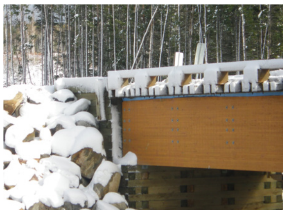
FIGURE 15 - Accumulation de neige pouvant causer une source d'humidité lors de la fonte (Source : MFFP)
