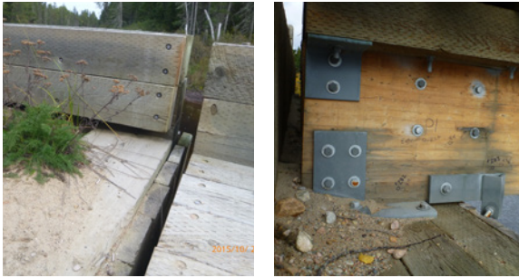
FIGURE 42 - Espace entre la culée et le platelage créant une accumulation de débris
