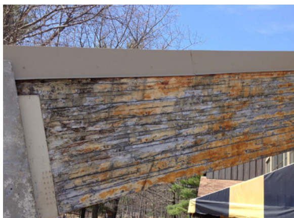
FIGURE 6 - Détérioration créée par le fendillement du produit de finition et de la surface du bois
