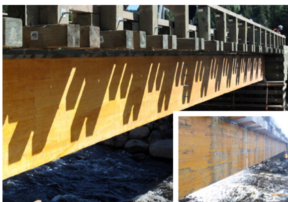
FIGURE 11 - Poutres en bois ayant une protection discontinue contre la pluie et les rayons UV (Source : Nordic Structures et Stantec [5] )
