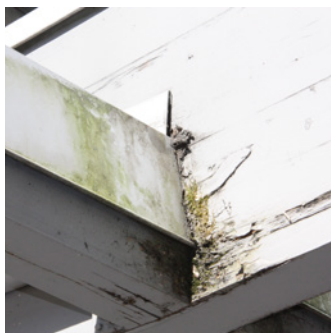
FIGURE 12 – Détérioration causée par le ruissellement de l'eau sur un solin
