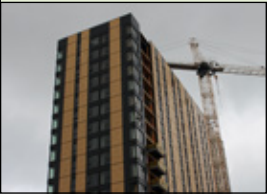
Résidence Brock Commons de l'Université de la Colombie-Britannique à Vancouver (18 étages) © Cecobois
