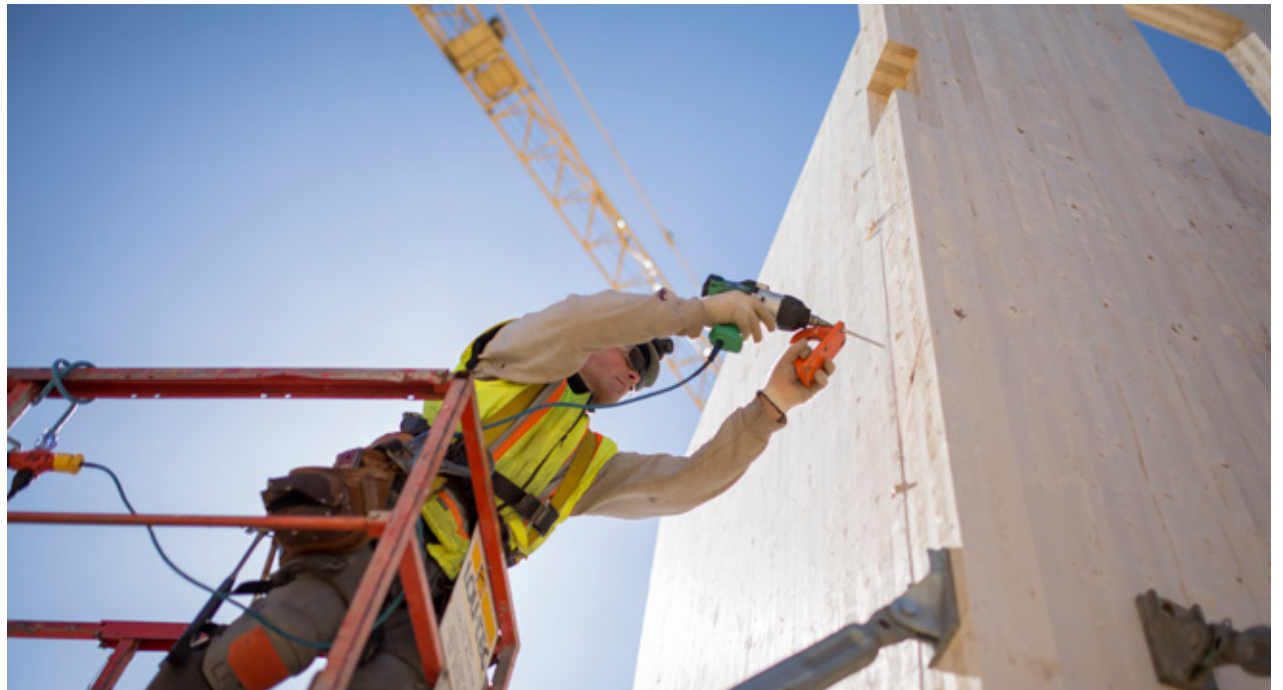
Les ferrures de levage sont retirées une fois le panneau CLT en place © Photo: Stéphane Groleau
