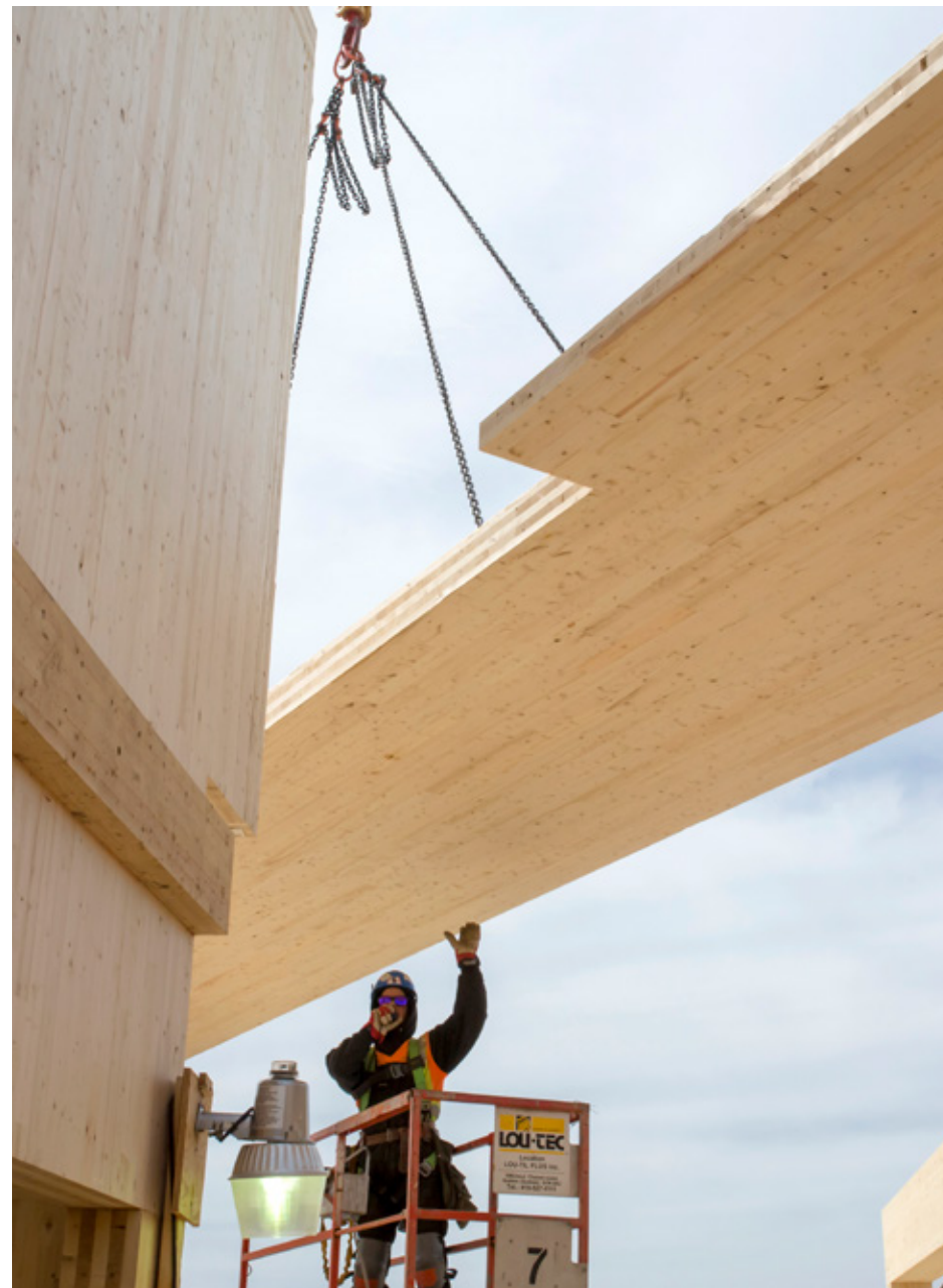
Installation d'une dalle de plancher, dont une petite portion viendra s'appuyer sur la lambourde fixée sur le mur © Photo : Stéphane Groleau
