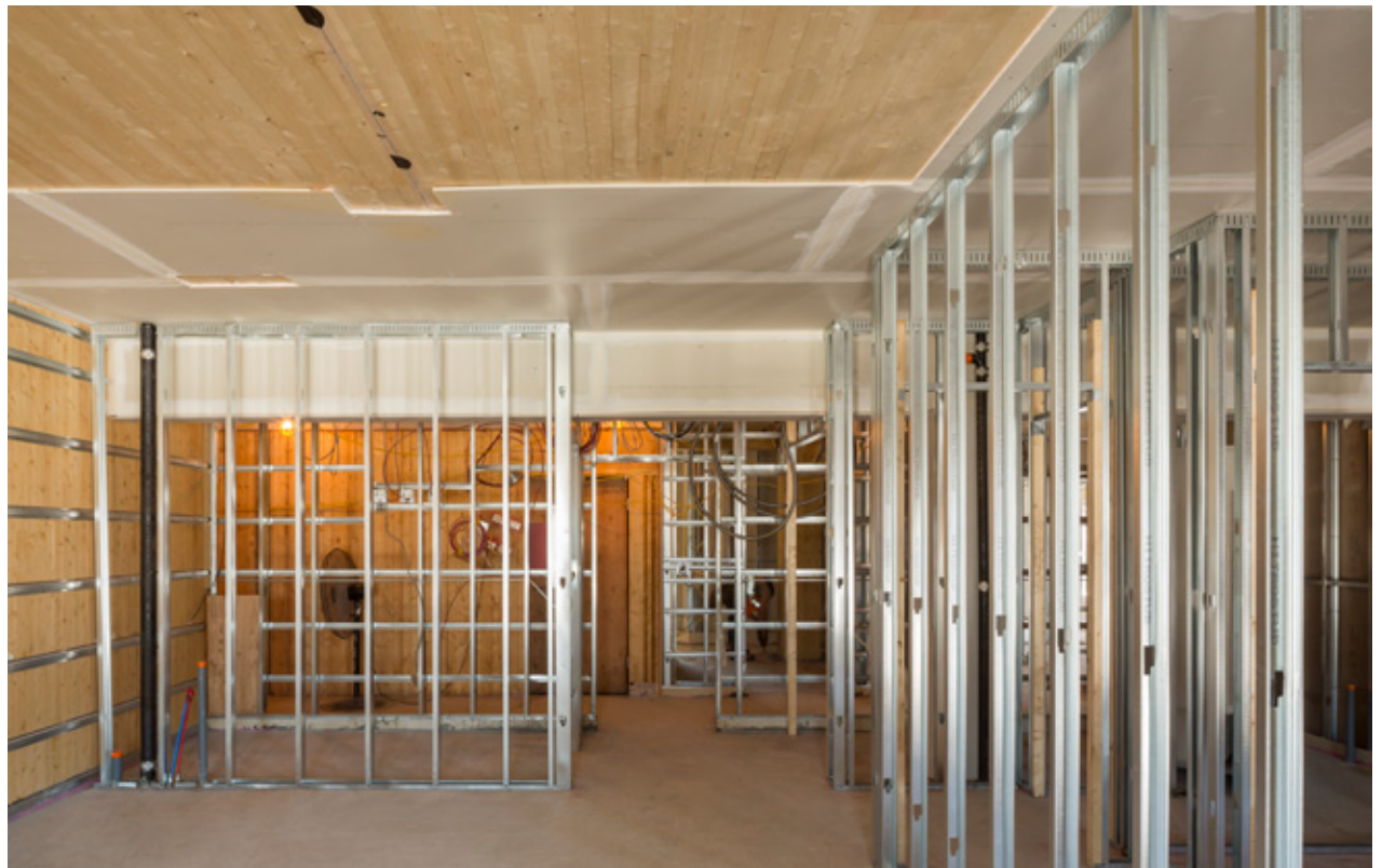
Montants métalliques pour réduire la charge combustible © Photo: Stéphane Groleau
