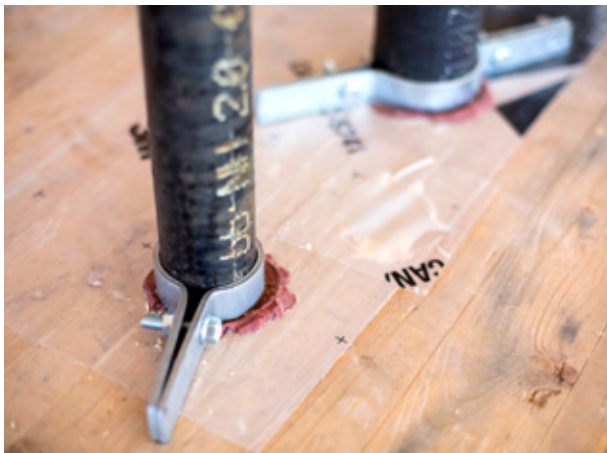
Scellant rouge assurant le degré de séparation coupe-feu autour des pièces d'équipement qui traversent un panneau de CLT © Photo: Stéphane Groleau
