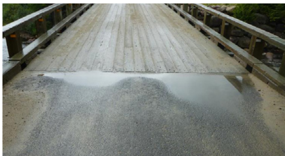
FIGURE 26 - Accumulation d'eau à l'approche (Source : MFFP et Stantec[5])
