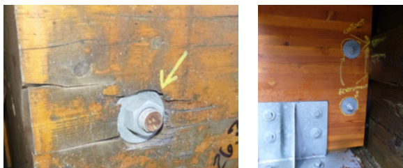
FIGURE 46 - Assemblages boulonnés endommagés par le gonflement du bois
