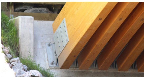
FIGURE 43 - Muret de béton protégeant les appuis
