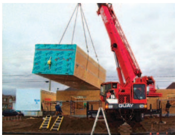
FIGURE 33 • Modules installés sur panneaux au rez-de-chaussée
