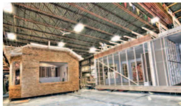
FIGURE 7 • Intérieur d'un module dans une usine (Goscobec)
