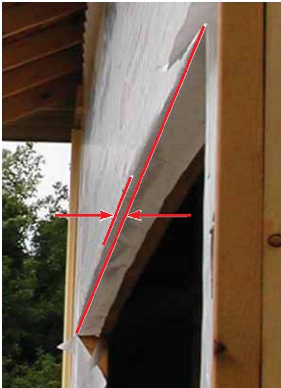
FIGURE 38 • Flambage d'un linteau en contrebas (photo : http://i-joist.org/policies-publications )
