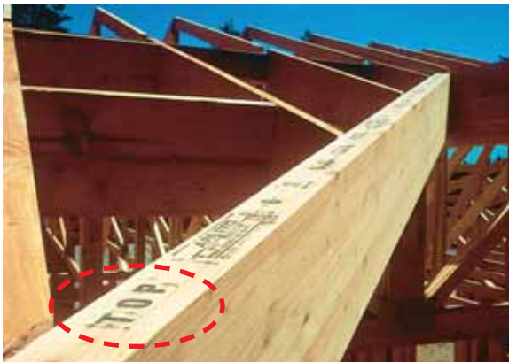
FIGURE 29 • Indication d'un bois lamellé-collé «débancé» (photo: APA-EWS)
