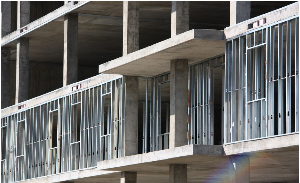
FIGURE 1 • Murs extérieurs non porteurs à ossature légère en acier léger pour un bâtiment en béton (source : Cecobois)
