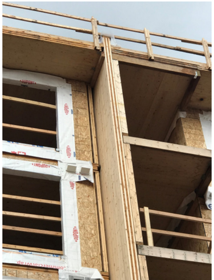
Figure 7. Mur coupe-feu de construction en bois d'oeuvre massif construit en Colombie-Britannique (photo: GHL Consultants)
