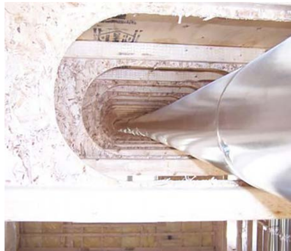
FIGURE 15 • Passage de la mécanique dans les poutrelles en I Crédit : Nordic
