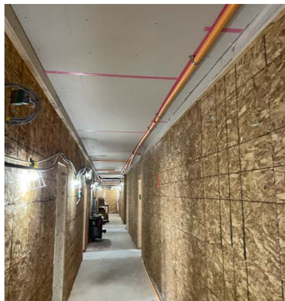
FIGURE 19 • Mécanique installée sous les solives
