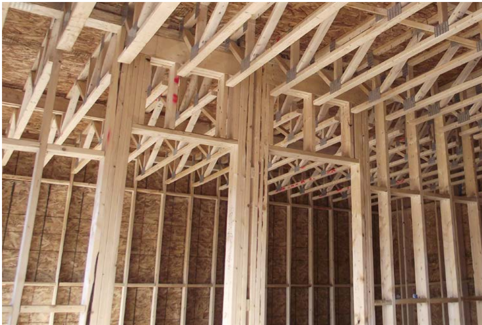
FIGURE 30 • Linteaux sous sablières dans un mur porteur dans un logement, poutrelles alignées avec montants, liens continus
